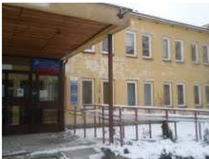
Budynek, w którym mieści się ośrodek jest dzierżawiony. Ze względu na stały brak pieniędzy Stowarzyszenia nie stać na przeprowadzenie koniecznych remontów i napraw.
